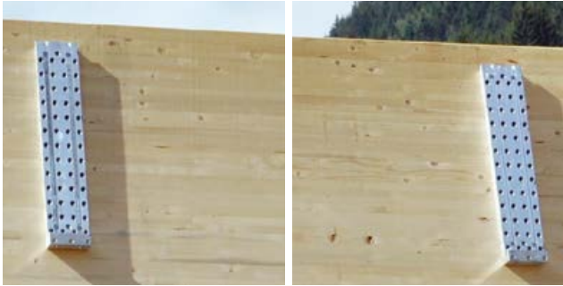
Montage avec emboîtement dans réservation en béton : distance d'accroche seulement 2 cm (sur côté opposé à la poutre principale bois)
